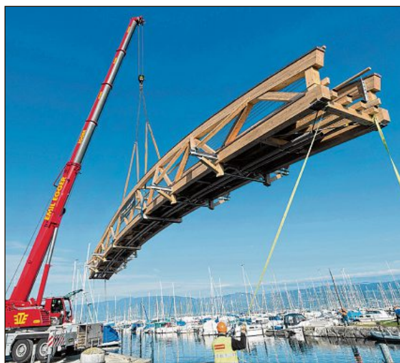
La nouvelle passerelle remplace l'ancien pont, dont la structure était vermoulue. CHARLY RAPPO
